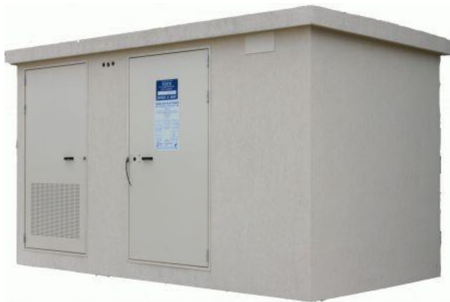
Exemple de poste de livraison – SNT DURIEZ
